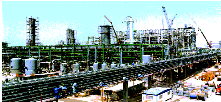
شکل ۴-۱ - یک پروژه پتروشیمی
